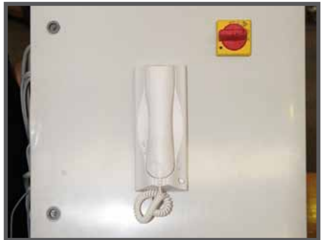
Щит питания обычно устанавливается на стене над гидравлическим блоком. На фотографии показана также телефонная трубка, которая используется для связи с коммуникатором, установленным на платформе.
